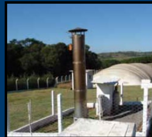
Uso de biodigestores
